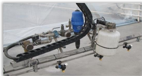
Rys. 35. Dozownik nawozów stosowany w systemach iniekcyjnych i zbiornik na środek ochrony roślin.
