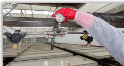
Rys. 38. Kontrola stanu technicznego manometru.
