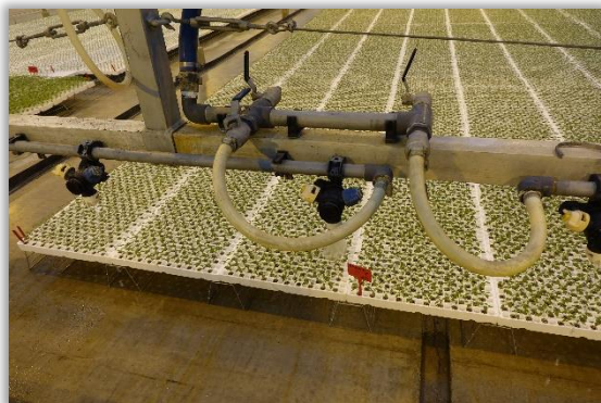
Rys. 47. Przewody cieczowe „zagrożone” samoopryskiem.
