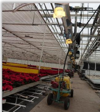
Rys. 77. Przy ocenie wizualnej jednolite rozpylacze powinny mieć jednolite kołpaki dla ich łatwej identyfikacji.
