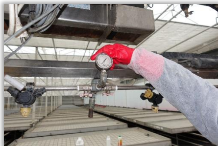
Rys. 42. Kontrola stanu technicznego manometru.
