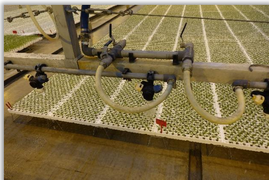
Rys. 49. Przewody cieczowe „zagrożone” samoopryskiem.
