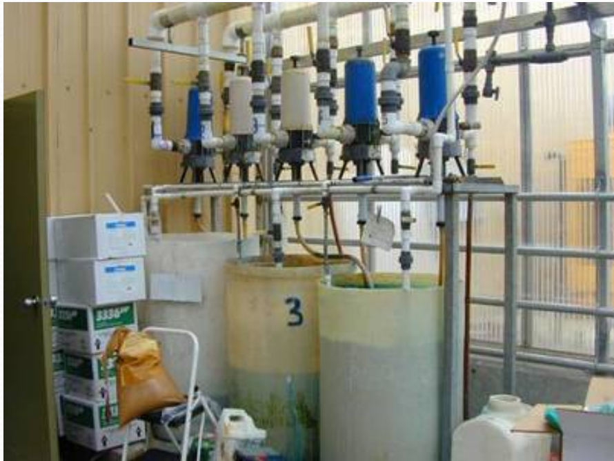
Fertygacja - injektory nawozów
