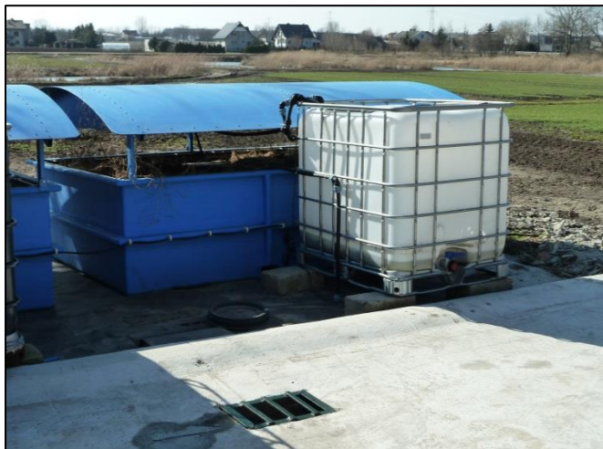
Rys. 26. Naziemny zbiornik na zanieczyszczonej wodę po myciu opryskiwaczy, gromadzoną w celu neutralizacji w stanowisku PHYTOBAC.
