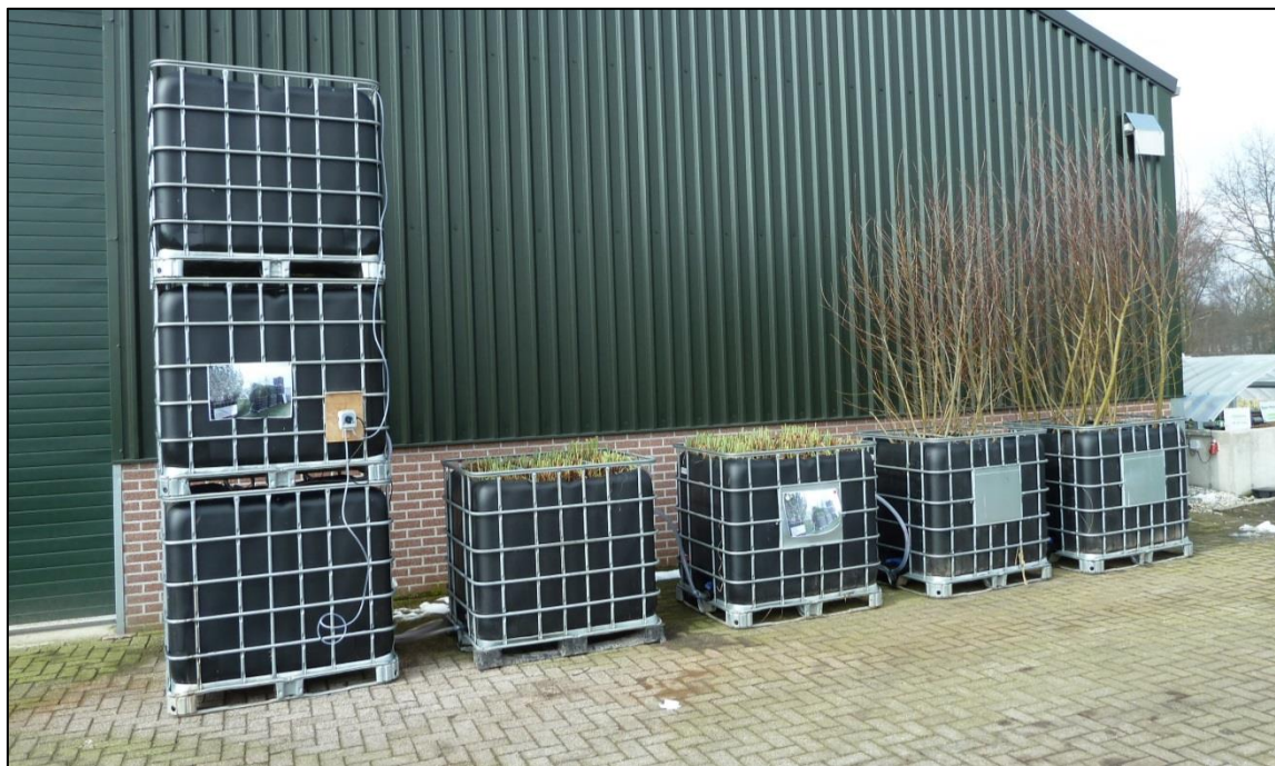
Rys. 45. Stanowisko BIOFILTERze zbiornikami na rośliny fitoakumulacyjne
