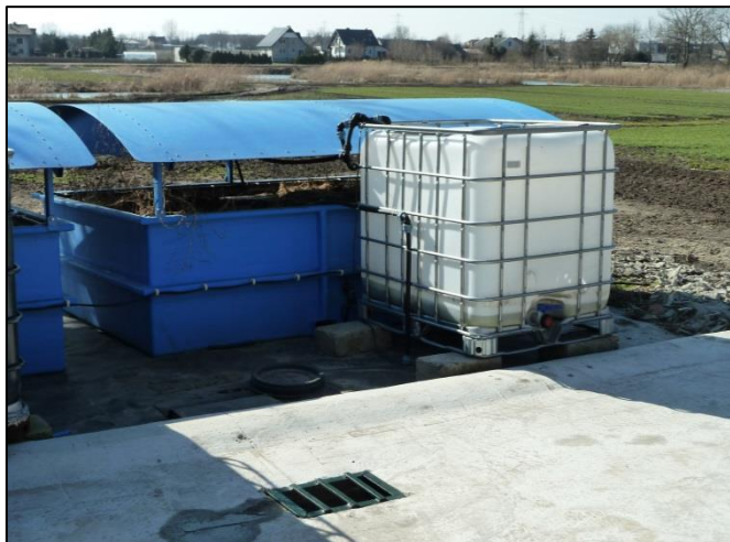
Rys. 26. Naziemny zbiornik na zanieczyszczoną wodę po myciu opryskiwaczy, gromadzoną w celu neutralizacji w stanowisku PHYTOBAC.
