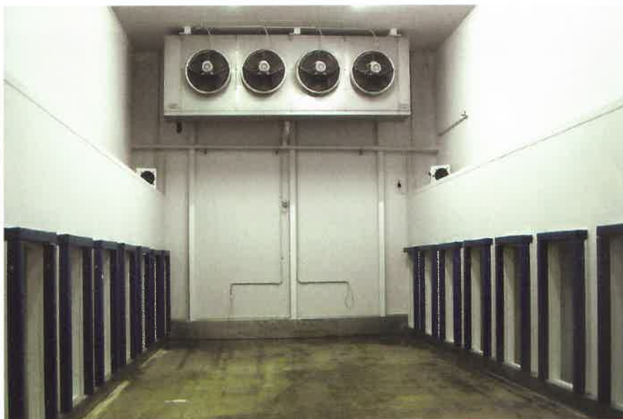
Fot. 2. System podwójnej ściany jest na stałe zainstalowany w komorze chłodniczej
