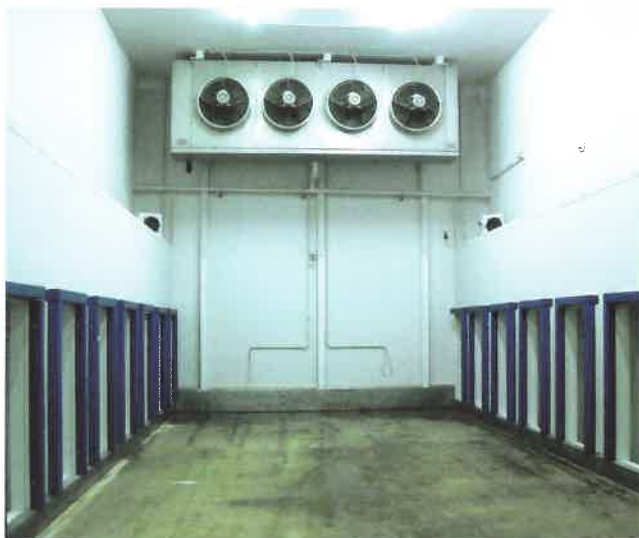
Fot. 4. System podwójnej ściany z wymuszonym przepływem powietrza na stałe, zainstalowany w komórze chłodniczej do schładzania czereśni
